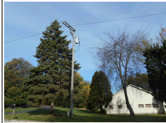
4 EXISTING TRANSFORMER ON UTILITY POLE SCALE: N.T.S.
