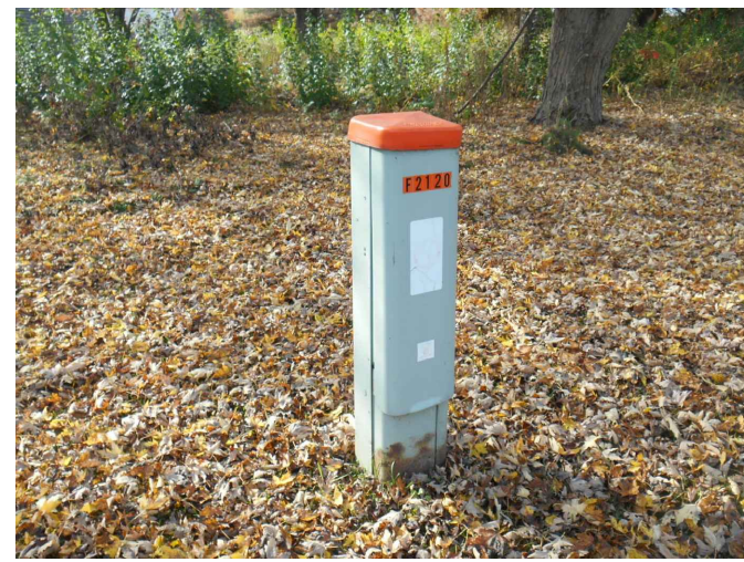
3 EXISTING FIBER TELCO PEDESTAL SCALE: N.T.S.
